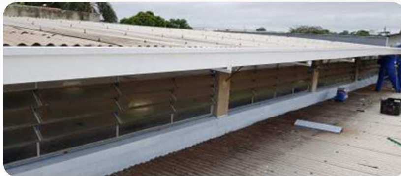
FOTO 5: DETALHE DAS CALHAS DO DETALHADO DO DEPAN
