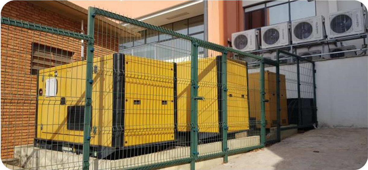
FOTO 1: GRUPOS GERADORES DE ENERGIA DOS DEPARTAMENTOS DA FEA.
