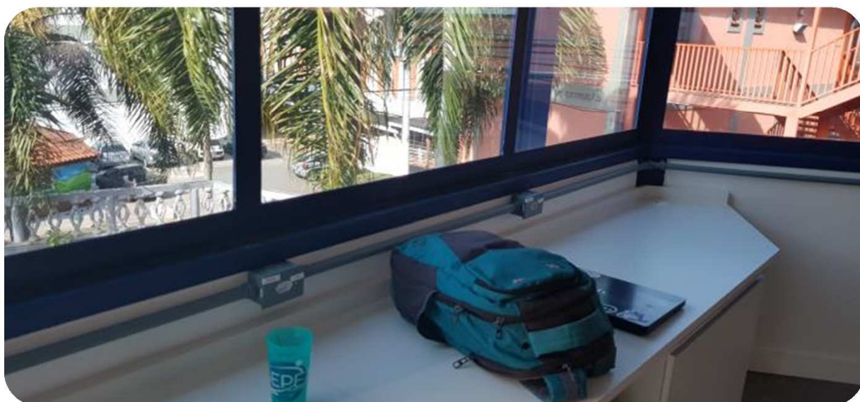
FOTO 4: FOTO DETALHE DA INFRAESTRUTURA ELÉTRICA E DE DADOS DA SALA DE REUNIÃO DO PRIMEIRO PISO DO GEPEA.
