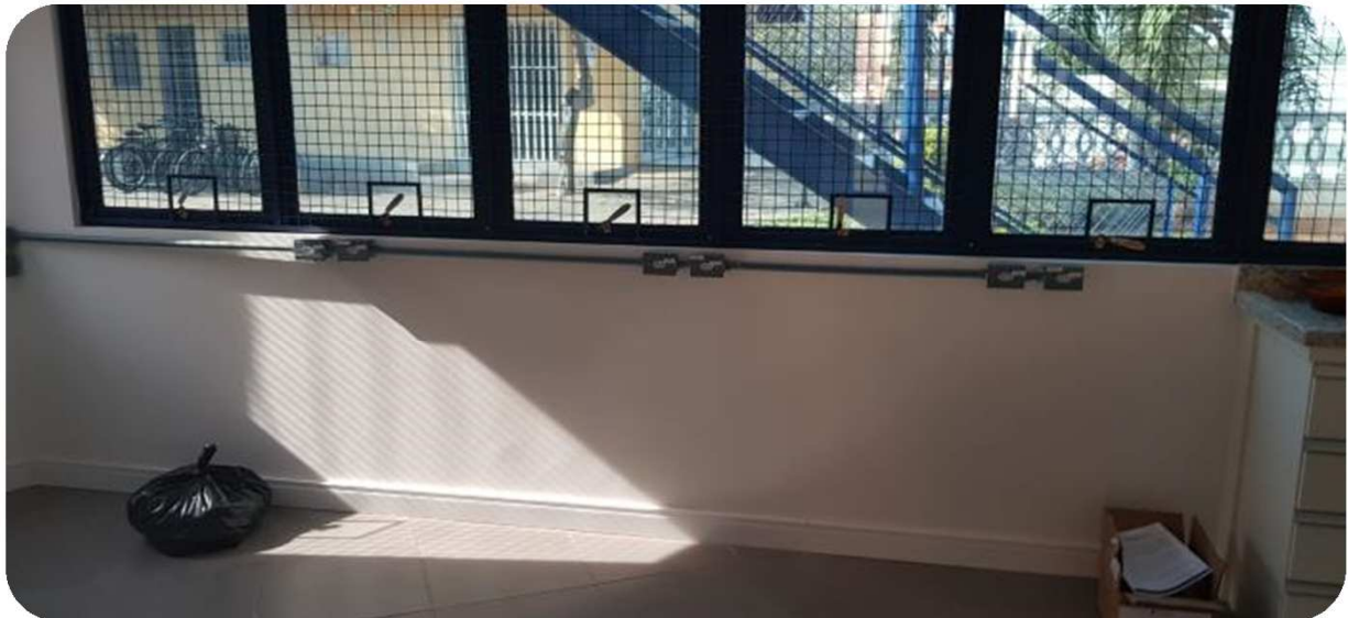
FOTO 2: FOTO DETALHE DA INFRAESTRUTURA ELÉTRICA E DE DADOS DA COZINHA DO GEPEA.
