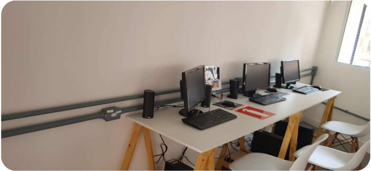
FOTO 1: FOTO DETALHE DA INFRAESTRUTURA ELÉTRICA E DE DADOS DO HALL DO PRÉDIO DO GEPEA.
