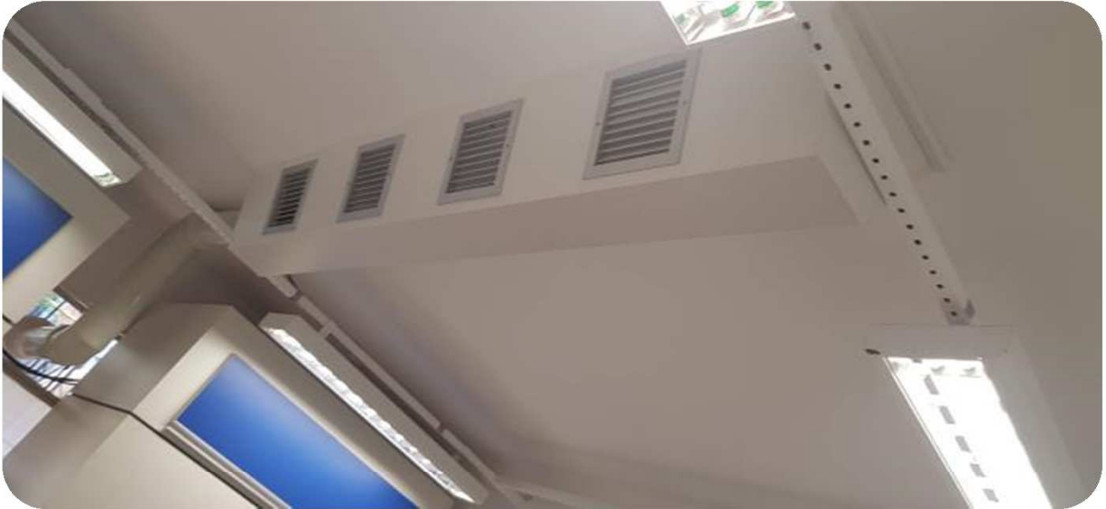
FOTO 1: CENTRAL DO SISTEMA DE EXAUSTÃO INSTALADO NO DEPAN.
