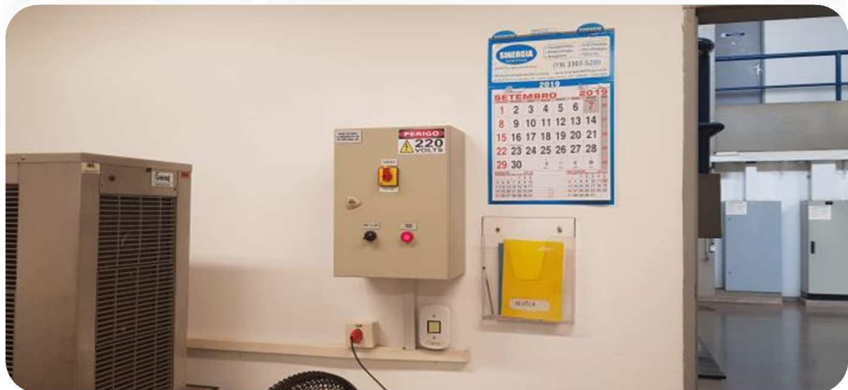
FOTO 2: QUADRO DE COMANDO DO SISTEMA DE EXAUSTÃO.
