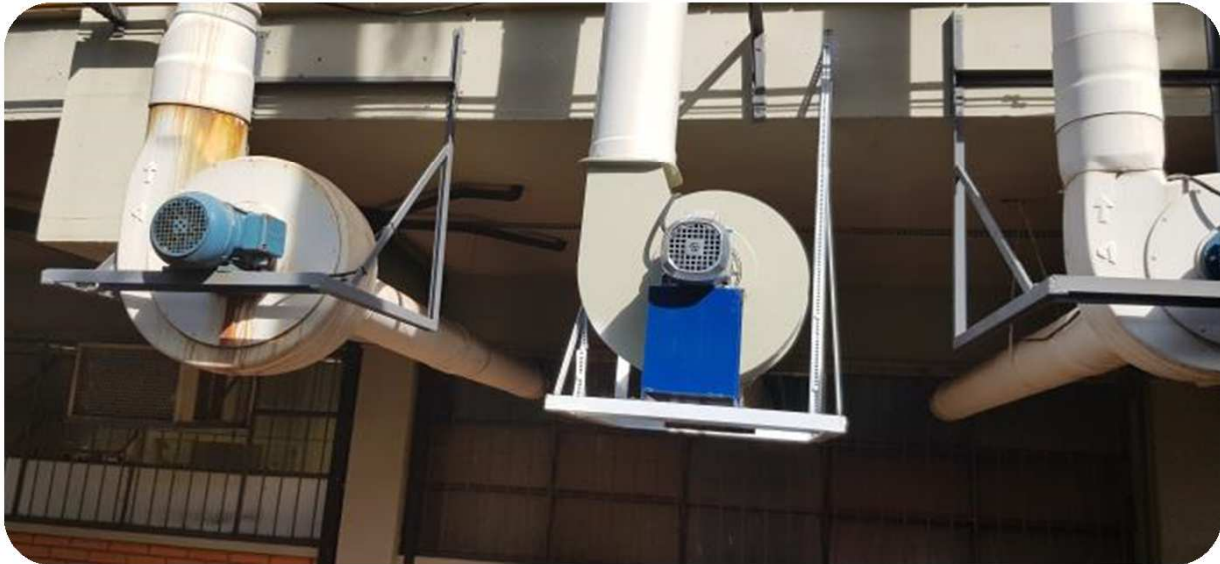
FOTO 3: MOTOR E TUBULAÇÃO DO SISTEMA DE EXAUSTÃO.
