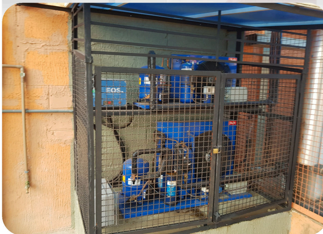
FOTO 4: Foto do abrigo das condensadoras das câmaras de resfriamento e congelamento. O sistema foi totalmente substituído, incluindo tubulação frigorígena. O sistema possui sistema de monitoramento remoto de temperatura.
