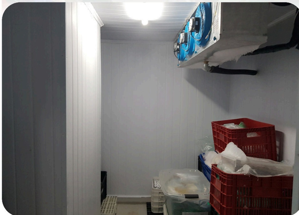
FOTO 3: Foto do ambiente interno da câmara de congelamento. Foi substituído o equipamento de congelamento, foi executado novo revestimento nas paredes e teto e foi executado pintura especial no piso.
