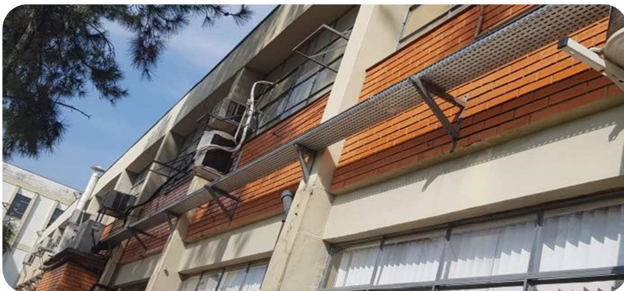
FOTO 3: CALHAS ELÉTRICAS 200 X 50 MM INSTALADAS NA PLANTA PILOTO DO DEA.
