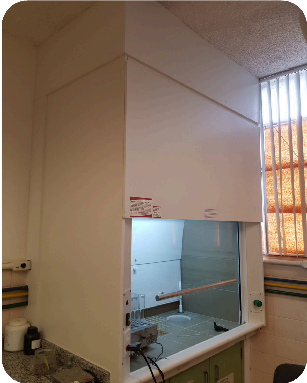
FOTO 1: Em destaque na imagem a capela de exaustão que foi instalada no LEP/DETA/FEA (DEA-20). Os materiais do interior da capela são adequados para digestão de proteína - que utiliza ácido.
