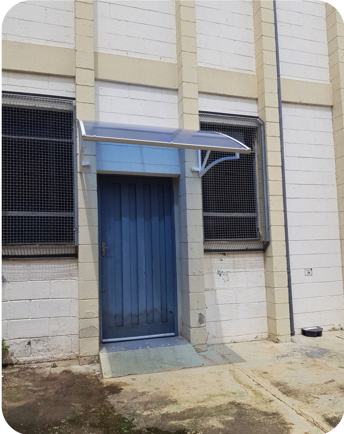
FOTOS 1: Detalhe da cobertura de policarbonato instalado na porta do LINA. Foram instalados duas coberturas de policarbonatos, sendo 1 na porta da frente e outra na porta do fundo do laboratório.
