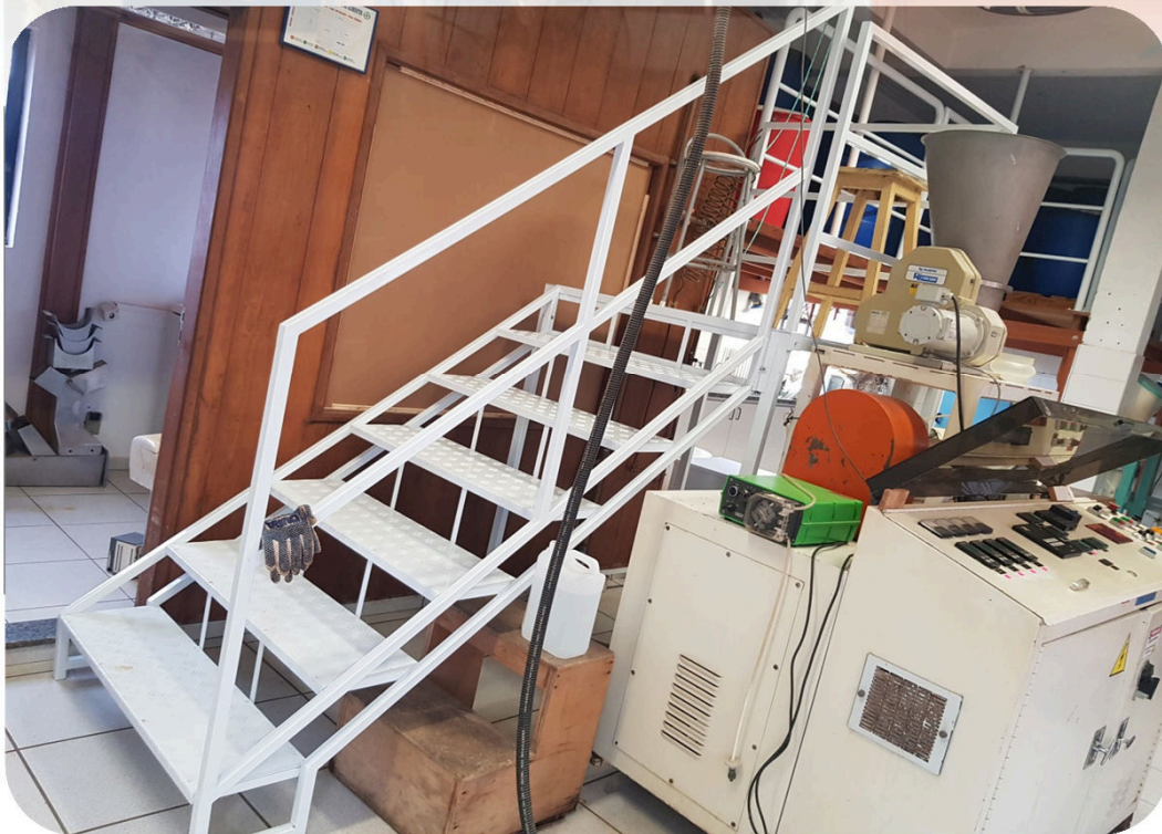
FOTO 2: Detalhe da escada metálica executada para possibilitar a alimentação, com segurança operacional, da extrusora do Laboratório de Extrusão - DTA/DETA/FEA. Estrutura montada de acordo com as normas vigentes.
