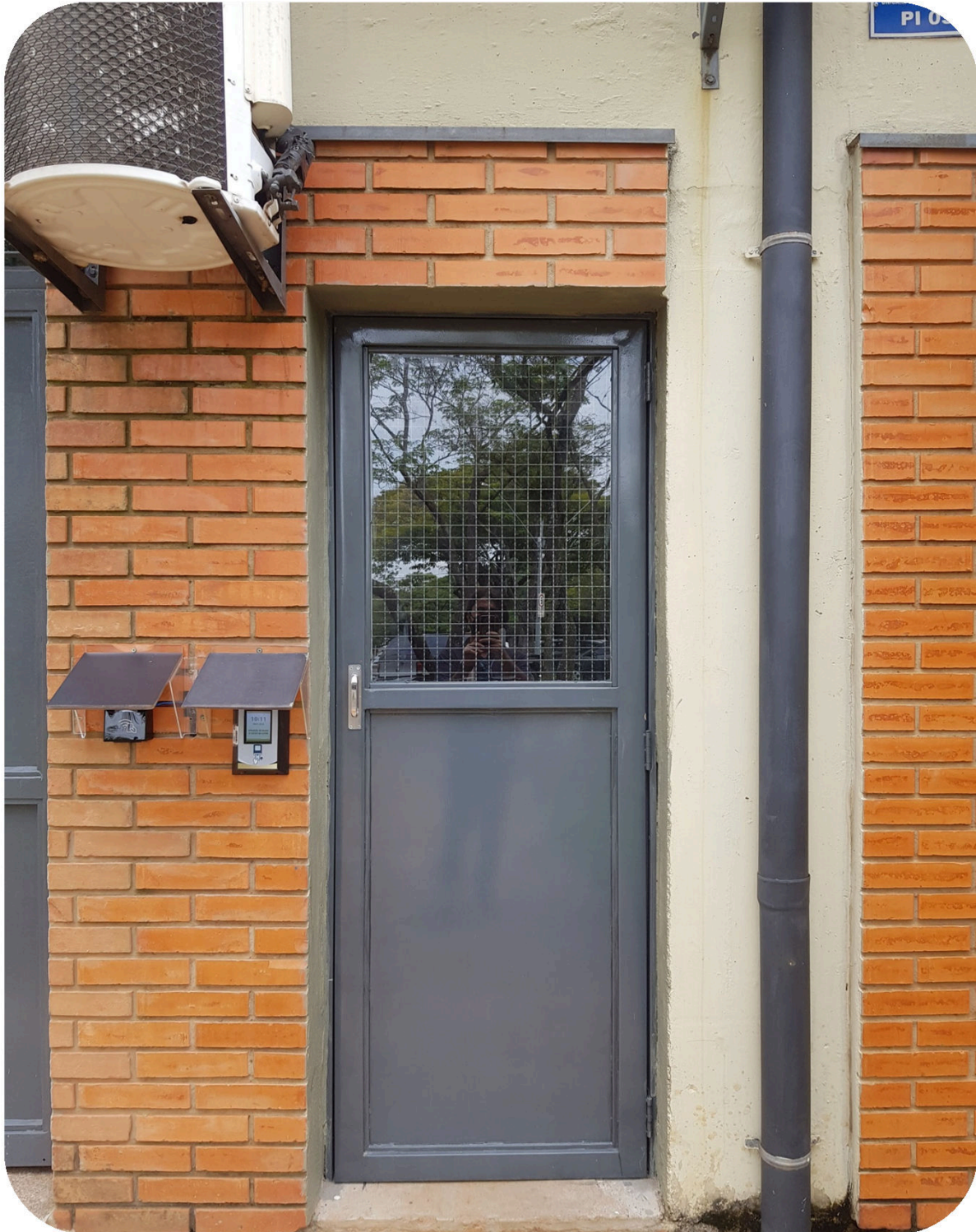
FOTO 1: Detalhe da porta metálica instalada no fundo do prédio da Planta Piloto do DEA/DETA/FEA. (FOTO EXTERNA).
