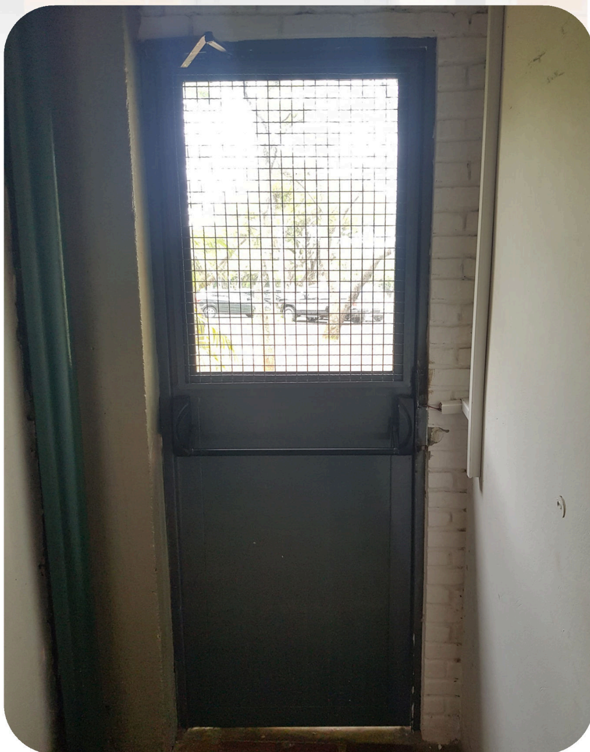
FOTO 2: Detalhe da porta metálica instalada no fundo do prédio da Planta Piloto do DEA/DETA/FEA. Como se trata de uma porta de emergência, foi instalado barra anti- pânico. (FOTO INTERNA).
